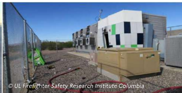
ARIA 54822 – Arrachement de la porte de l'ESS à la suite de l'explosion, propulsant certains pompiers à plus de 20 m
